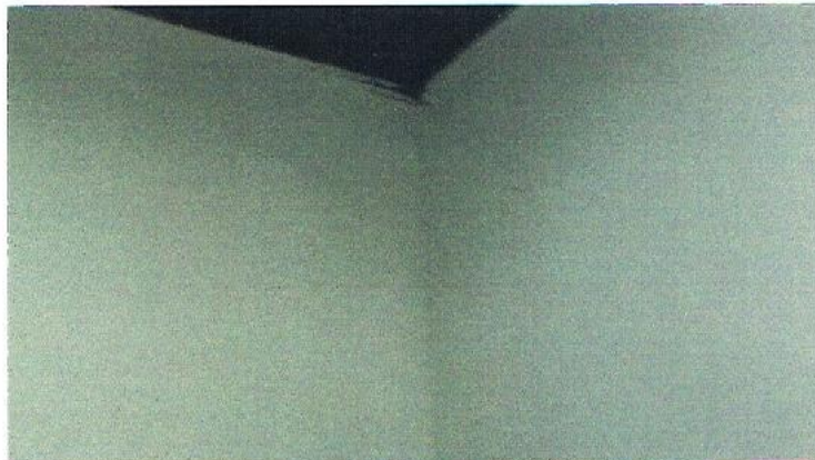
4. PAREDE COM INFILTRAÇÃO (01/03/2016)
