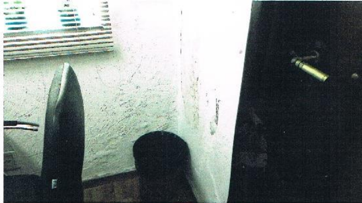
1. PAREDE COM INFILTRAÇÃO (01/03/2016)
