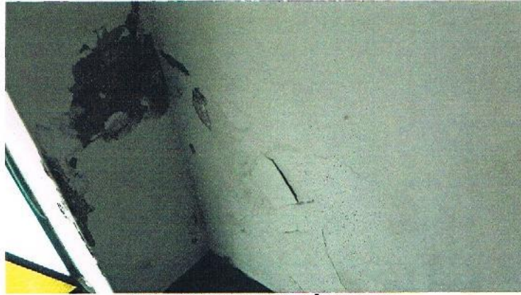
3. PAREDE COM INFILTRAÇÃO(01/03/2016)
