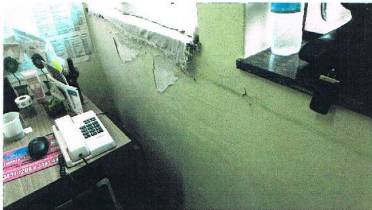
2. PAREDE COM INFILTRAÇÃO (01/03/2016)
